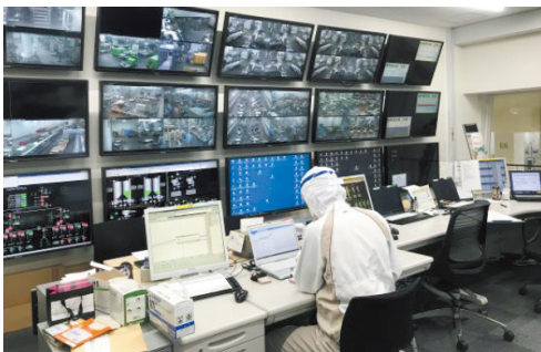
コントローラー室
